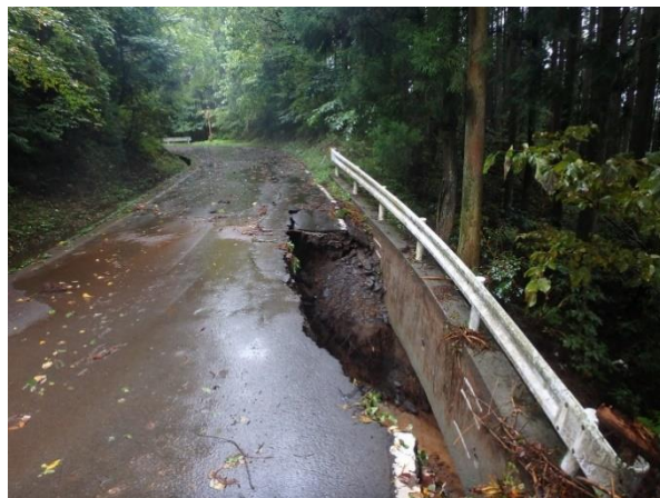
写真：崩壊した林道（北箱根山線）
