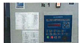
環境制御盤の導入
