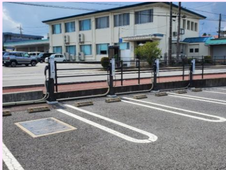
② EV 充電器
