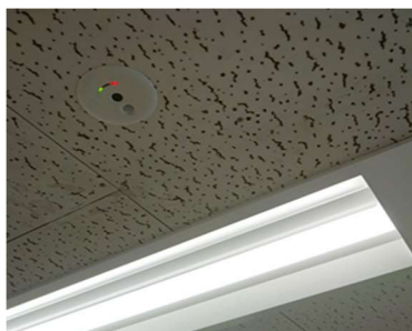
センサーとLED照明
