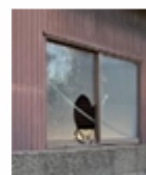
窓が割れた 管理不全空家
