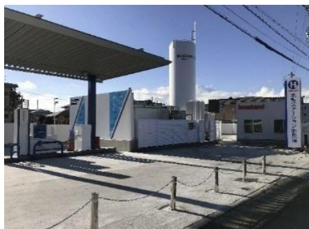
市内に誘致した水素ステーション
