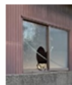
窓が割れた 管理不全空家
