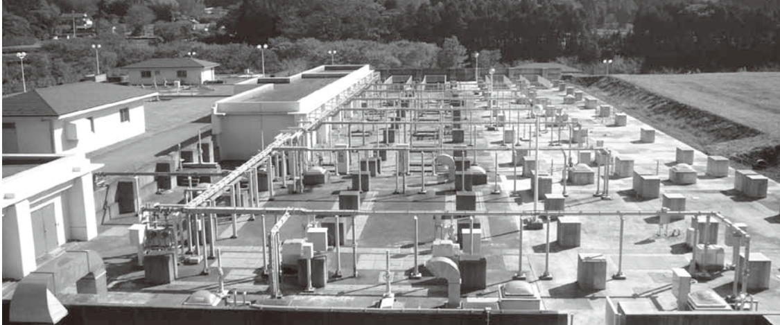
▶ 浄化センターの下水処理施設
