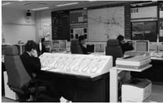
▲更新された通信指令室
